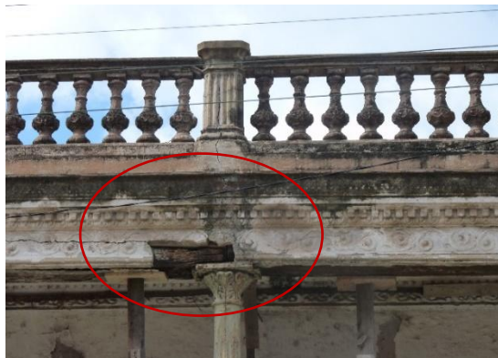
Fig. 4 Detalle de fachada donde, por el deterioro y la pérdida del recubrimiento de la estructura de madera, se aprecia la viga de madera que soporta el pretil, recubierta por frisos decorados.
